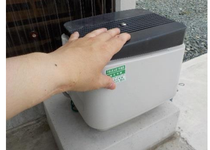
簡易チェックは主に送風機の点検
