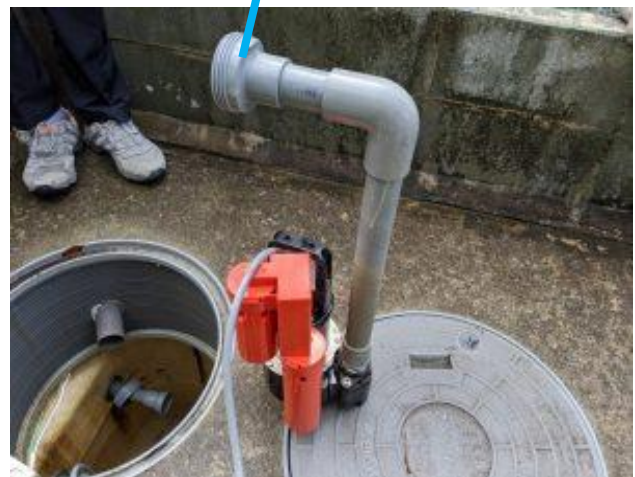
槽内に排水ポンプを設置 水害時に強制排水を行う装置
