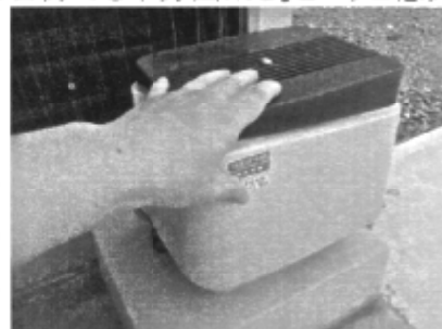
簡易チェックは主に送風機の点検
